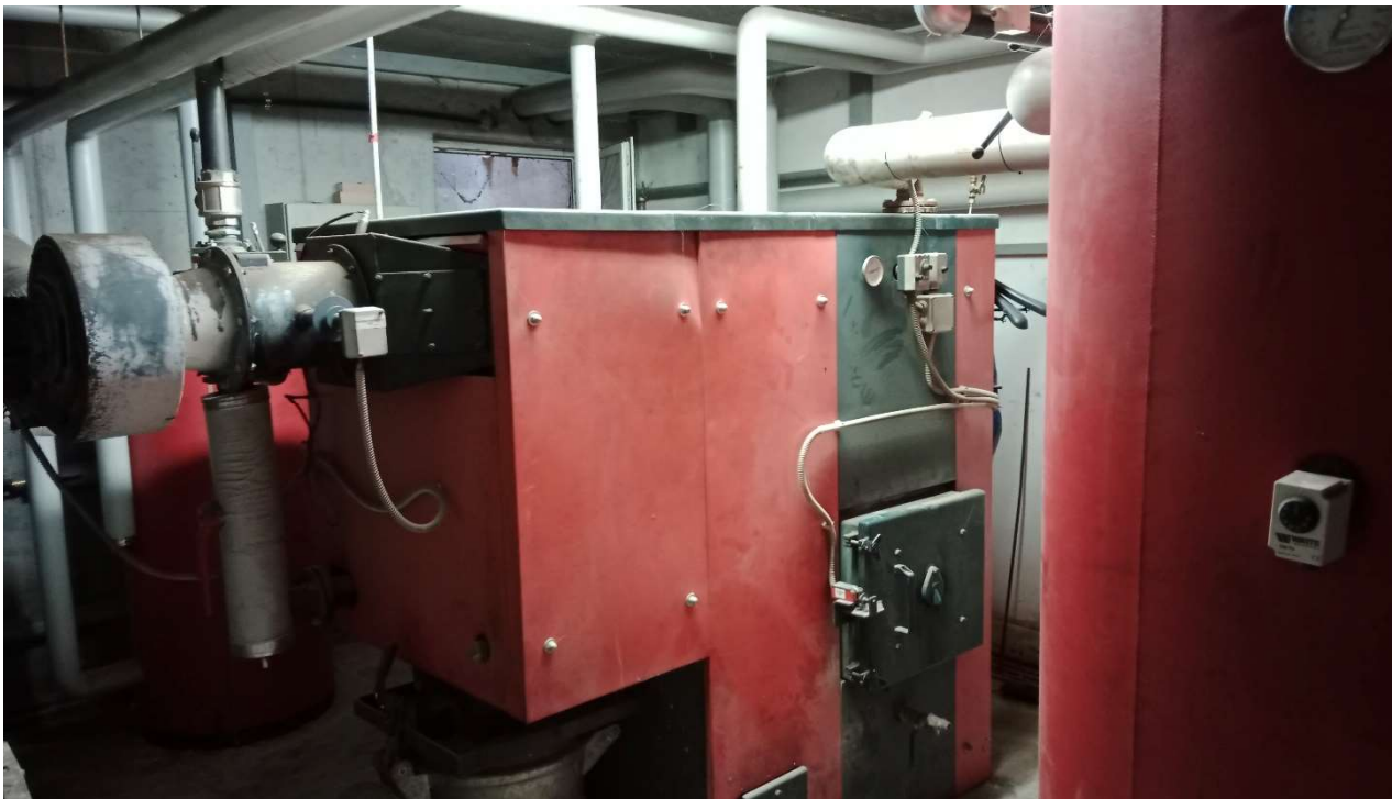
Centrale termica piano -2
